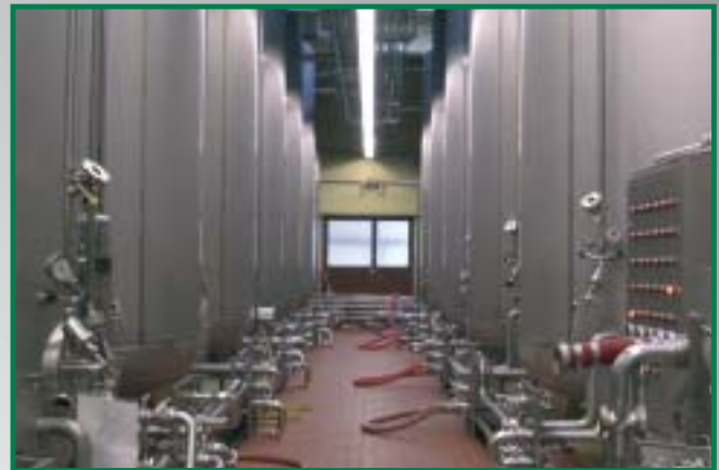
Lagertanks mit Gesamtkapazität von 12 Mio Liter.
